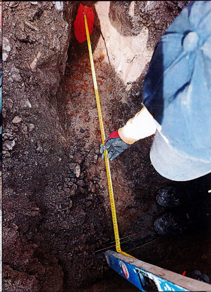
sondaj nr.13 str.Kossuth Lajos
