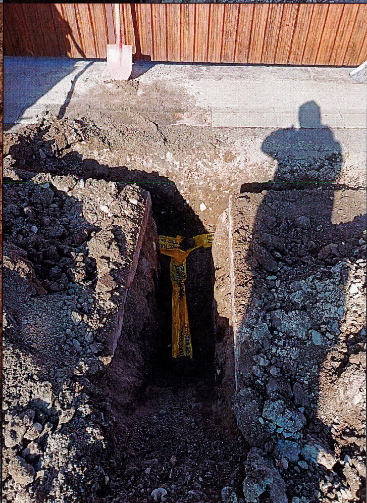
sondaj nr.11 str.Kossuth Lajos
