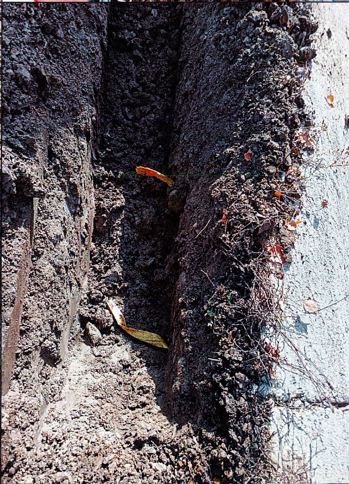
sondaj nr.14 str.Kossuth Lajos
