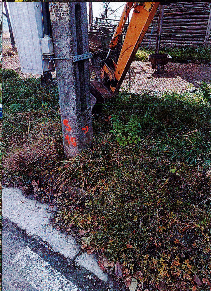
sondaj nr.15 str.Kossuth Lajos
