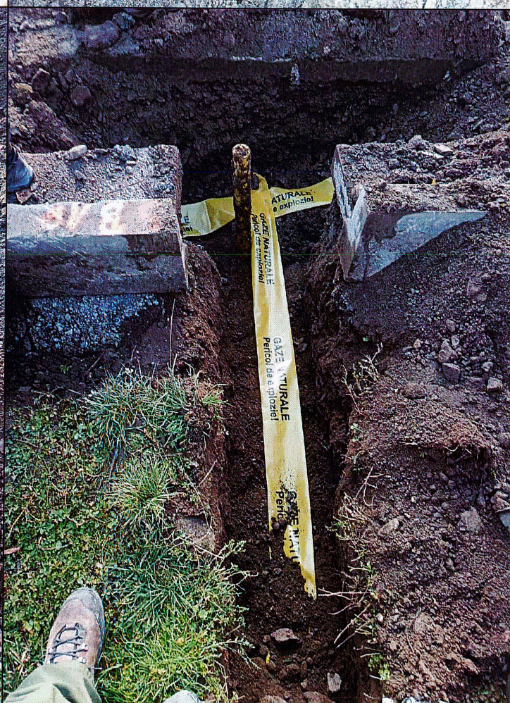
sondaj nr.10 str.Kossuth Lajos
